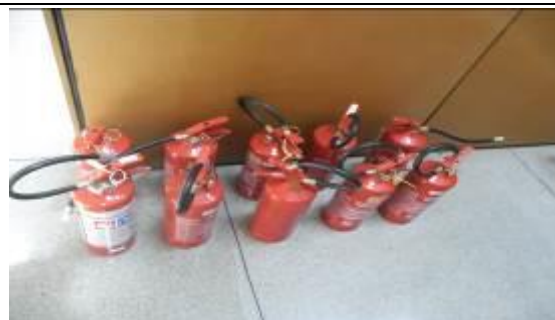
Foto 02 – Recarga dos extintores continuação
